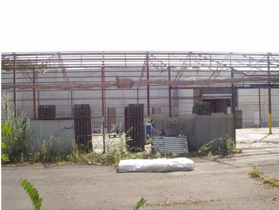
Teilweise abgerissene Werkshallen
